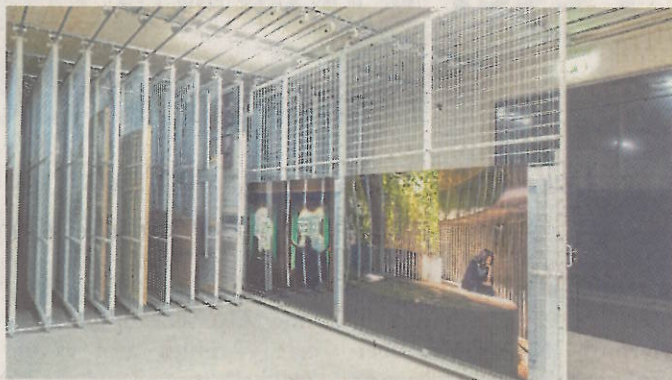
Im Depot kann auf 800 Quadratmetern Kunst gelagert werden. Die Klimatisierung erfüllt alle konservatorischen Ansprüche.
